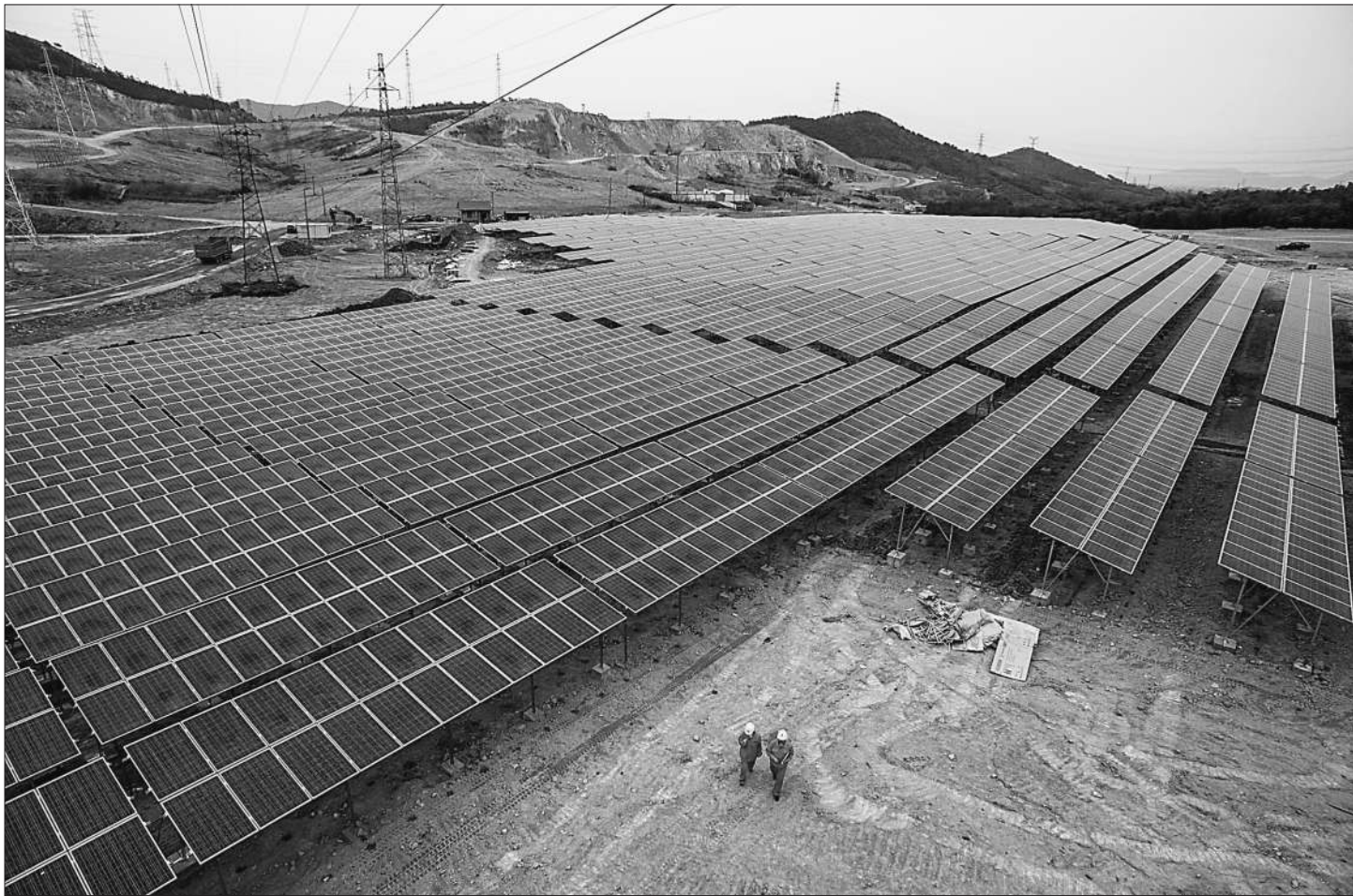
今年,浙江省湖州市妙西“贝盛光伏项目”租赁妙西镇原废弃矿区及周边区域约700亩土地。项目建成后将集光伏发电、中药材与现代农业种植于一体,每年可为湖州减少6600吨的标煤使用量,减少1730吨二氧化碳排放。图为3月30日工作人员在检查由废弃石矿改建而成的发电设备。
