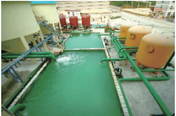
开磷集团磷煤化工基地废水循环装置
