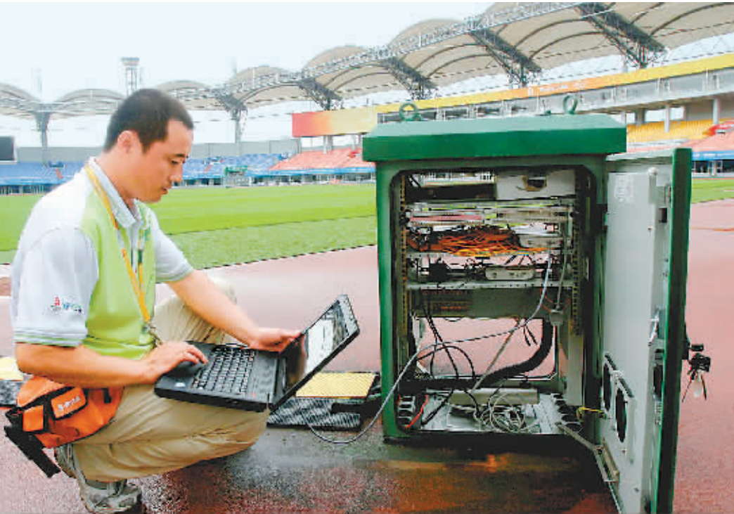
在北京奥运足球秦皇岛分赛区，技术人员对赛场内的通信、网络设施进行检查测试。
