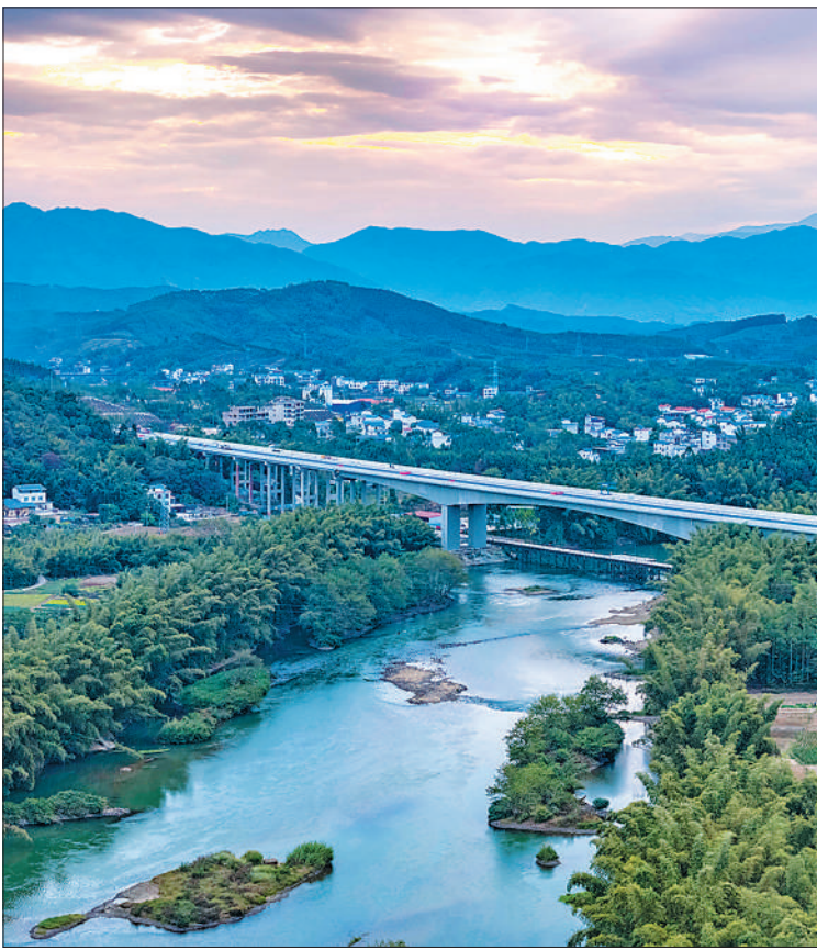
11月27日,广东清远连山至广西贺州高速公路贺江特大桥项目,桥面施工作业正在进行。近年来,贺州市大力推进交通基础设施建设,不断完善立体交通网络布局。连贺高速公路项目建成后将进一步完善广西高速公路网络,推动沿线经济社会发展。黎黎图摄(影像中国)
