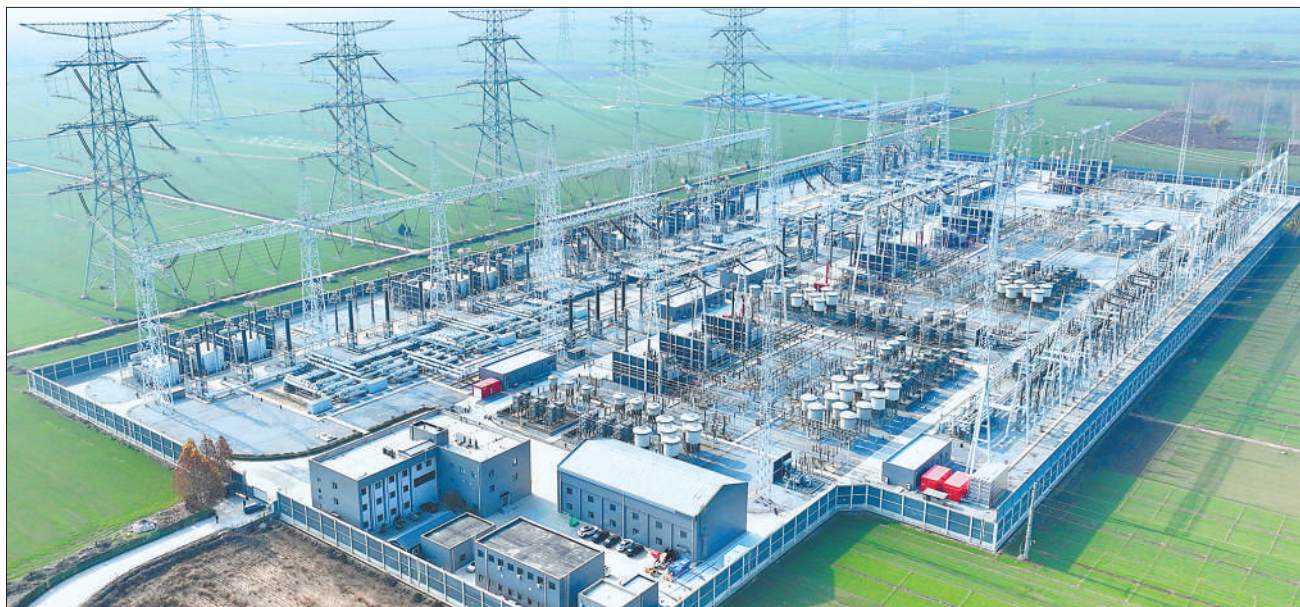
11月19日，位于河北省定兴县境内的雄安1000千伏特高压变电站扩建工程投运，扩建后变电容量从600万千瓦增加至1200万千瓦。据介绍，该站是张北至雄安1000千伏特高压交流输电工程的终点变电站，是京津冀负荷中心的重要枢纽，是连通雄安新区清洁能源大通道中的关键站点。
