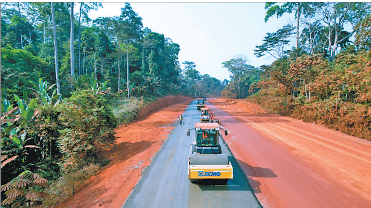
喀麦隆吕—曼金公路位于该国苏博拉高原南部，是首都雅温得连接北部各地区的重要通道，其中96.7千米管段由中铁二十局承建。近日，该管段全线沥青路面摊铺顺利完成。图为吕—曼金公路沥青路面摊铺现场。徐国萍摄
