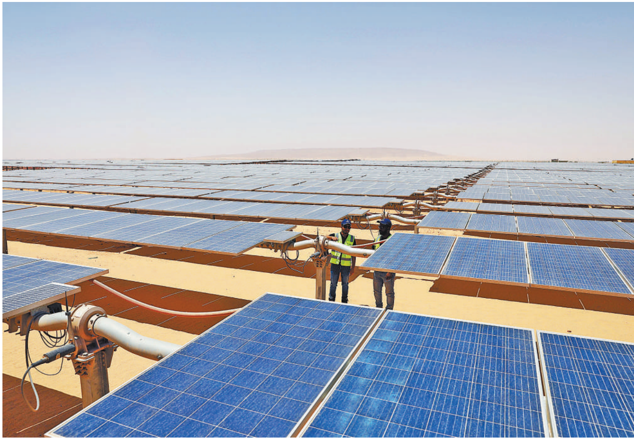
在埃及南部阿斯旺省沙漠腹地的本班光伏产业园内，一排排光伏面板将充沛的光照资源转化为当地居民生产生活离不开的宝贵电能。图为工人对光伏面板进行巡检。
