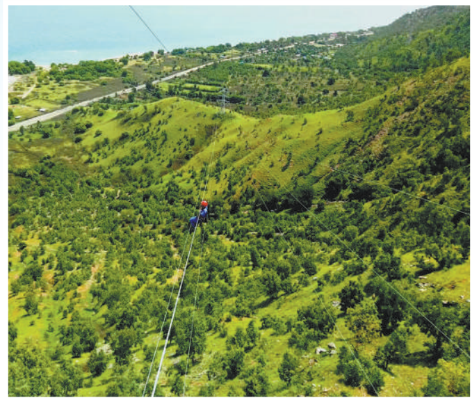
▲技术人员正在对东帝汶国家电网150千伏高压输电线路进行高空检修。希拉里奥摄
