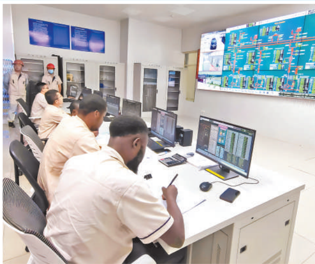
在中企投资建设的刚果(金)布桑加水电站中控室内，工作人员在监控设备运行状态。余立强摄
