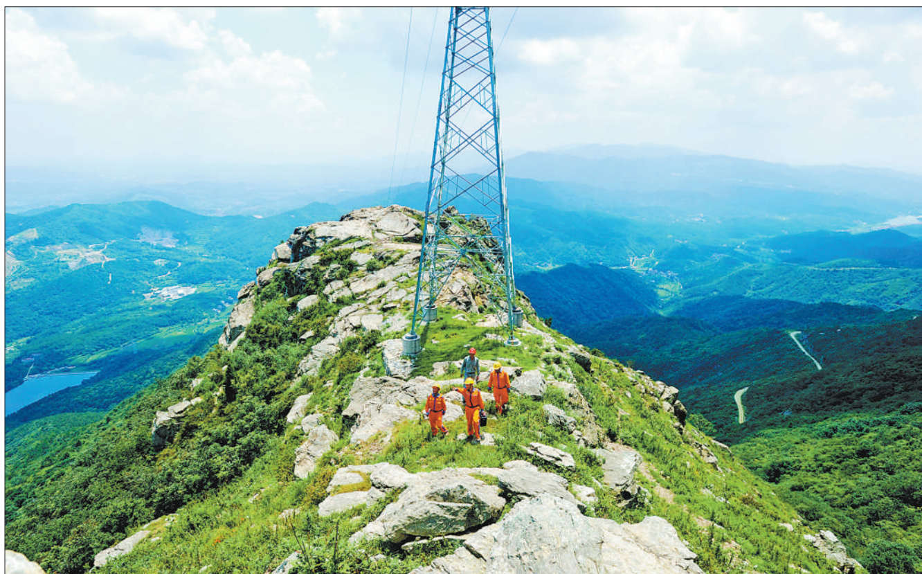
近年来，湖北孝昌县利用风、光资源禀赋，发展新能源产业，当地电力部门加大风电、光伏建设力度，截至目前，新能源装机容量达到68.92万千瓦。图为日前，工作人员在大悟山上巡查新能源输电线路。余健兵摄（影像中国）
