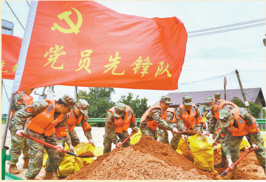
江西省南昌市新建区民兵党员先锋队装填防洪沙袋。 李龙伊 卢成行摄影报道
