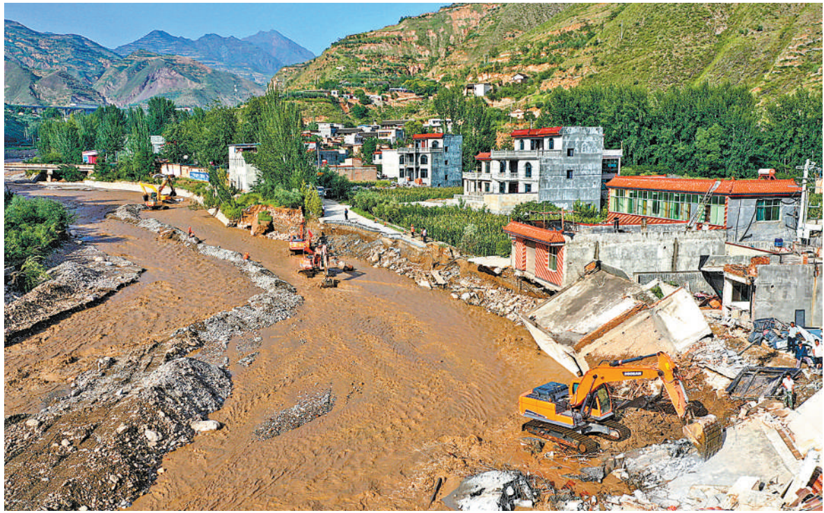
7月25日，在甘肃省陇南市武都区三河镇竹林村，救援人员抢修水毁路段。新华社记者 郎兵兵摄
