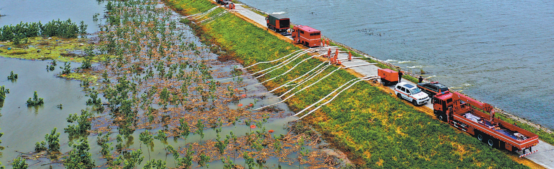
7月9日，湖南省岳阳市华容县团洲垸洞庭湖一线堤坝，消防救援等队伍正在抽排积水，力争早日恢复群众生产生活秩序。
