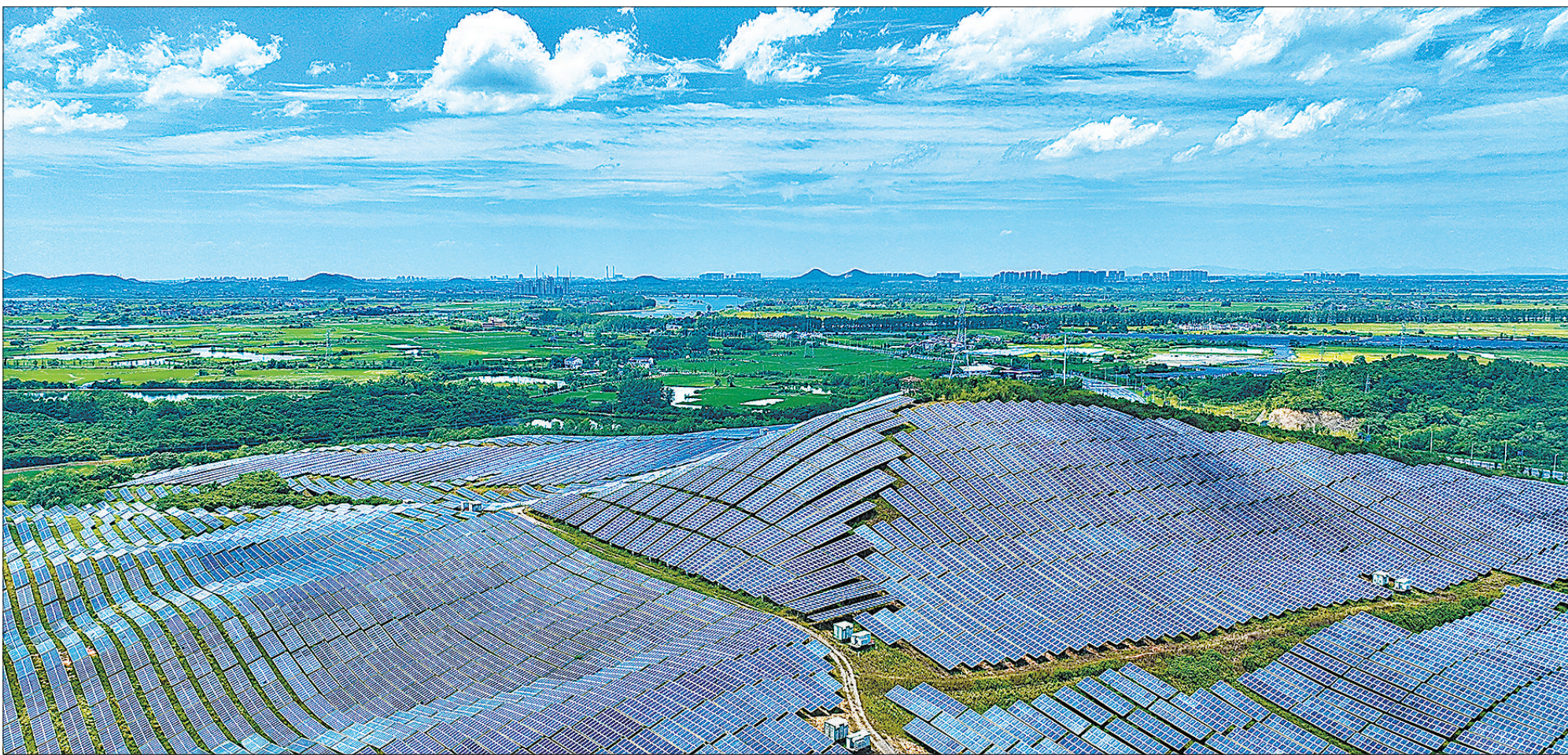
7月7日，安徽省芜湖市弋江区峨桥镇，蓝色的光伏电板有序排布，在阳光的照射下熠熠生辉。近年来，弋江区结合当地日照资源丰富的优势，高效利用荒山发展光伏发电产业，助力乡村振兴。钱鸣摄（影像中国）
