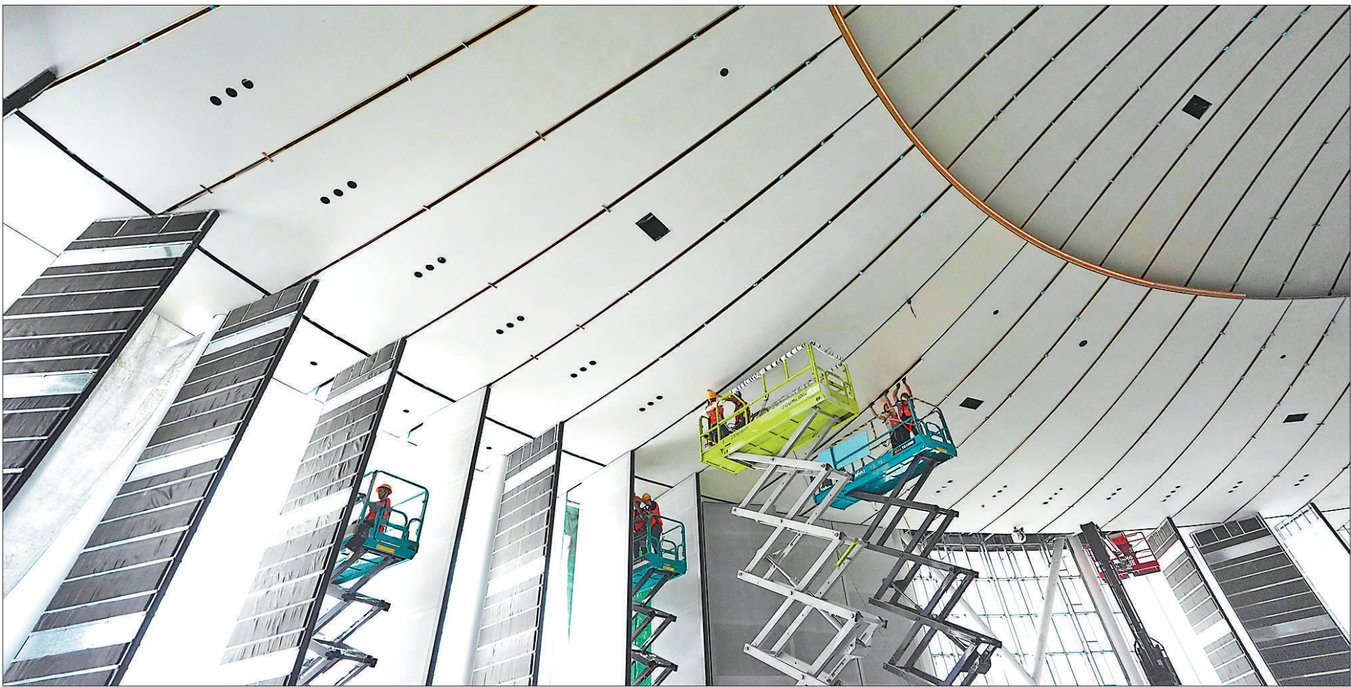
国家会议中心二期工程赛后建设有序推进,目前已进入内部精装冲刺阶段。国家会议中心二期在2022年北京冬奥会和冬残奥会期间承担了主媒体中心职能,预计2025年正式投入使用,将成为承载北京国际交往中心功能的一张新名片。图为工作人员在国家会议中心二期工程内部施工。新华社记者 鞠焕宗摄
