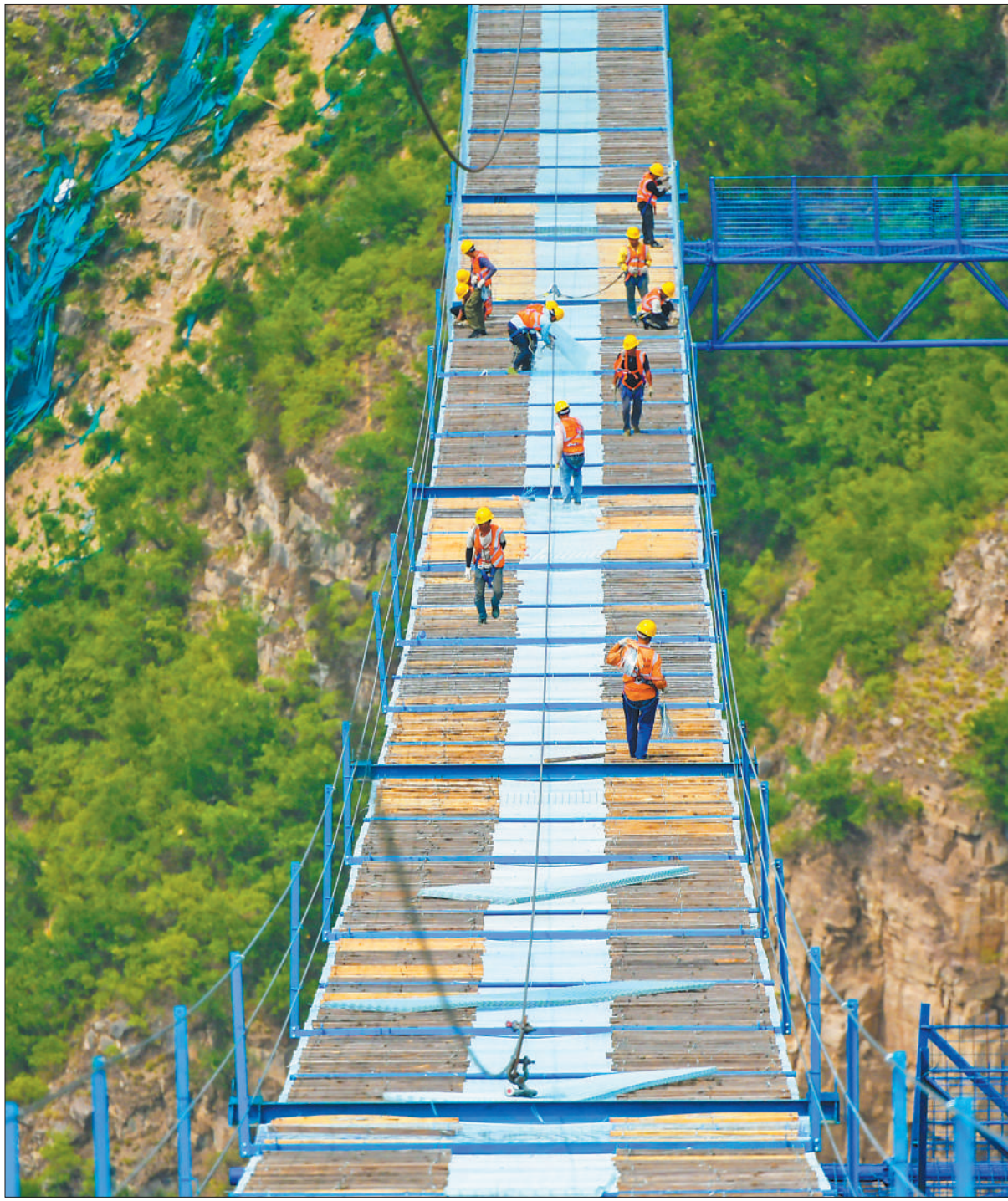
5月31日，济（河南省济源市）新（新安县）黄河大桥上部结构施工加紧推进，工人们进行大桥桥道建设，为后续大桥主缆架设做准备。济新黄河大桥位于济源市、新安县交界处的王屋山—黛眉山世界地质公园，是济新高速公路的控制性工程。
