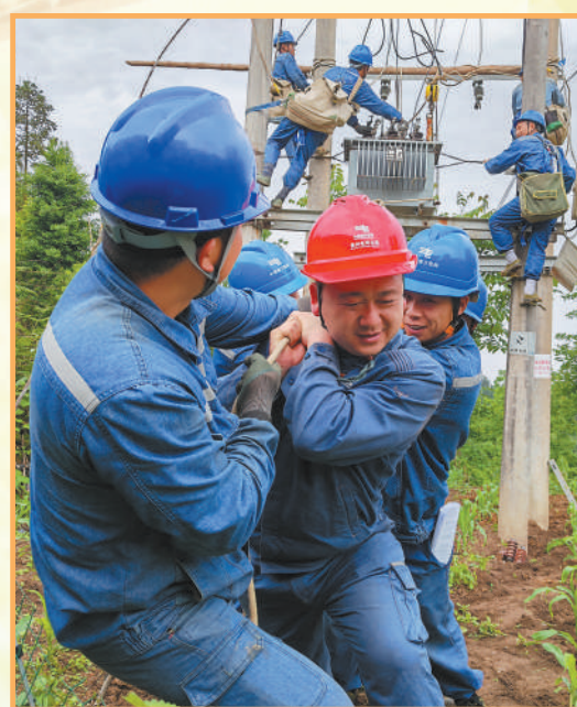
5月8日，南方电网贵州电网公司遵义务川供电局配电中心工作人员正在进行变压器增容作业，保障夏收用电。 王君辉摄(人民视觉)
