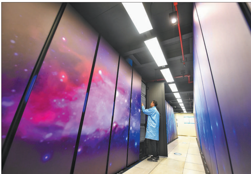
成都超算中心科研人员在巡检机房设备。
