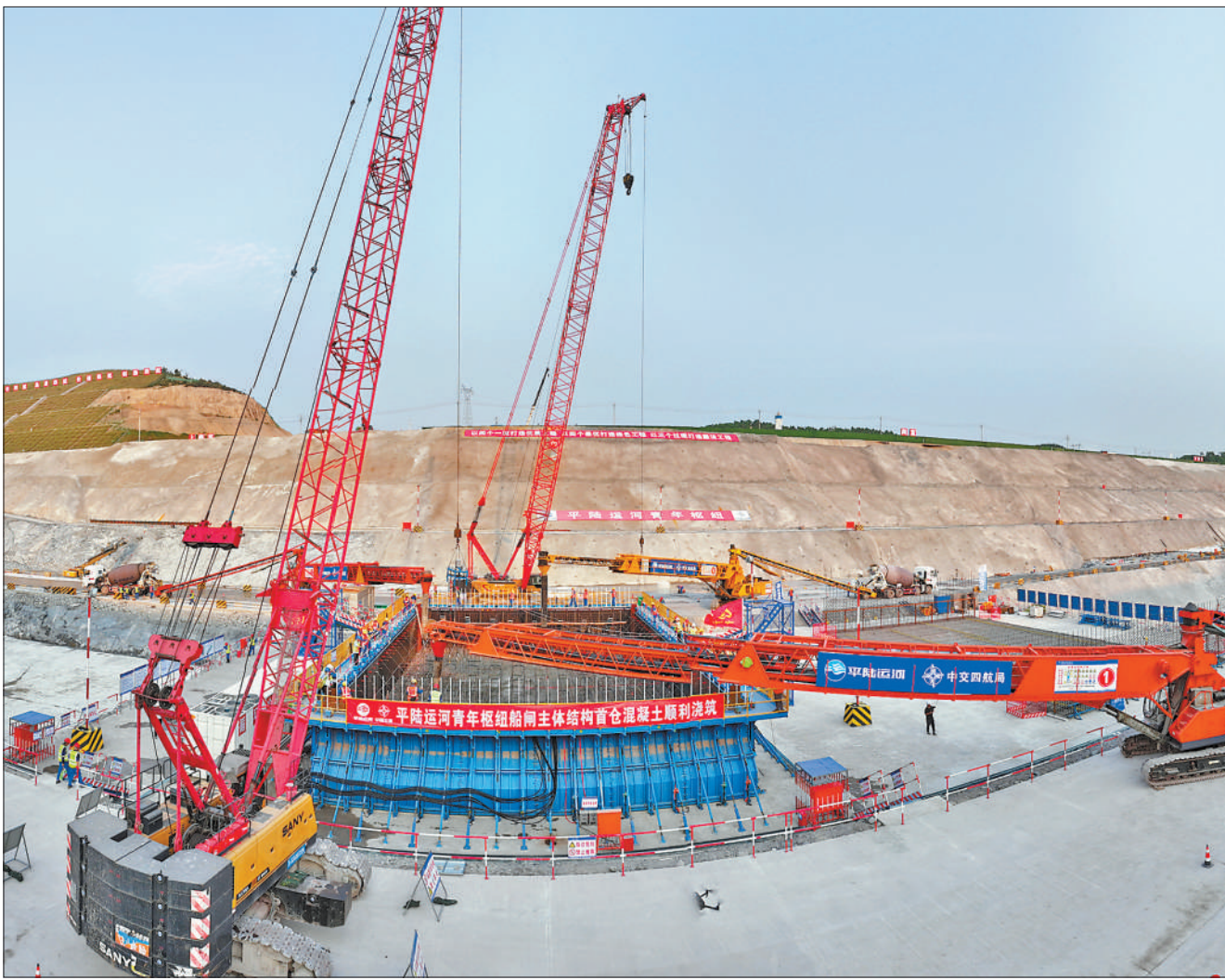
4月28日,随着广西壮族自治区平陆运河青年枢纽船闸主体结构首仓混凝土顺利浇筑,平陆运河青年枢纽正式进入船闸主体结构建设阶段。青年枢纽是平陆运河规划3座梯级中的最下游梯级,主要施工内容为双线船闸、泄洪闸、电站、连接坝和鱼道。图为平陆运河青年枢纽船闸主体结构首仓混凝土浇筑现场。
