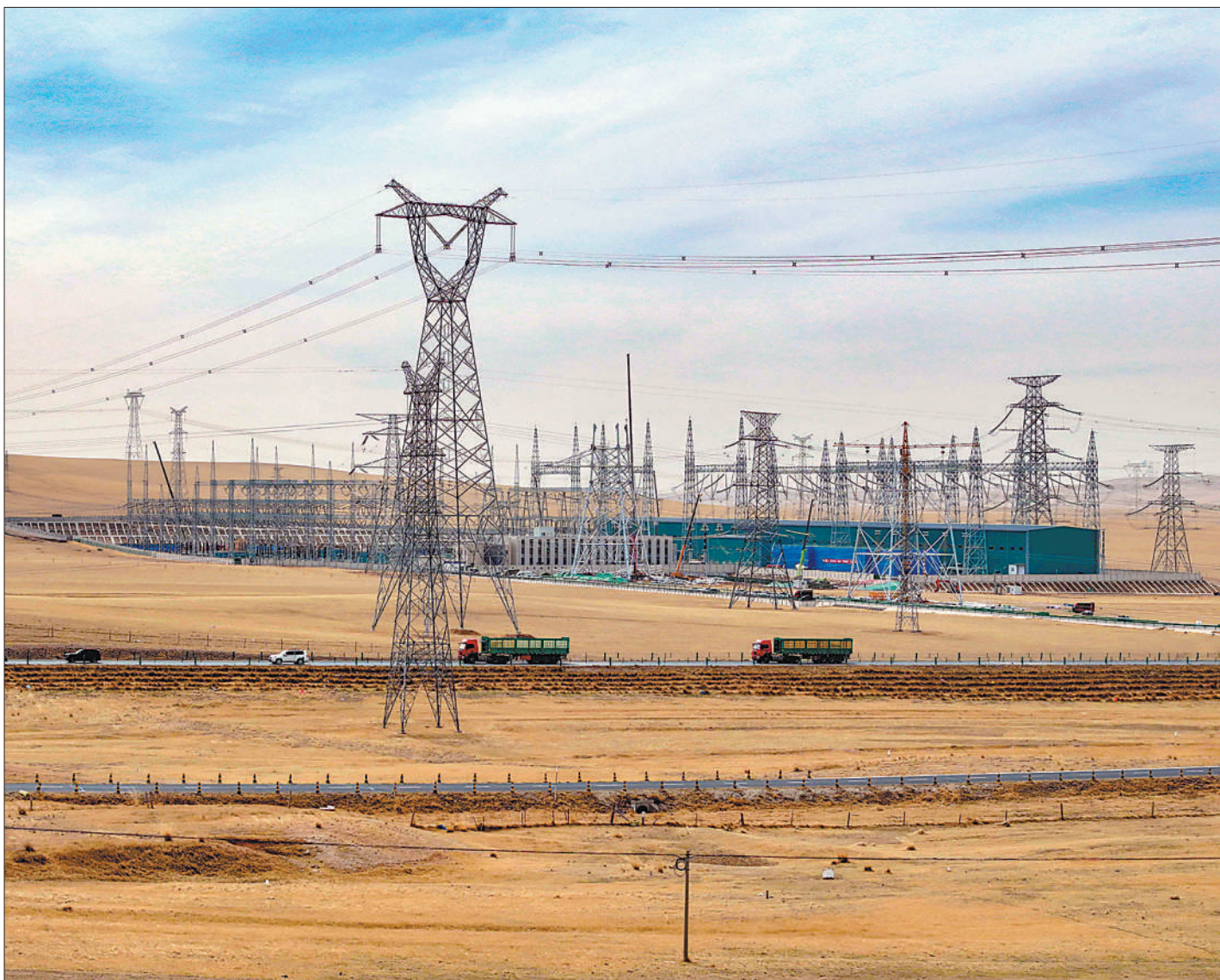
张北—胜利1000千伏特高压输电交流项目,起于河北省张家口市张北变电站,止于内蒙古自治区锡林浩特市胜利变电站,是我国“西电东送”国家电网重要组成部分,也是内蒙古第八条特高压输电通道项目工程,计划年内投入运行。
