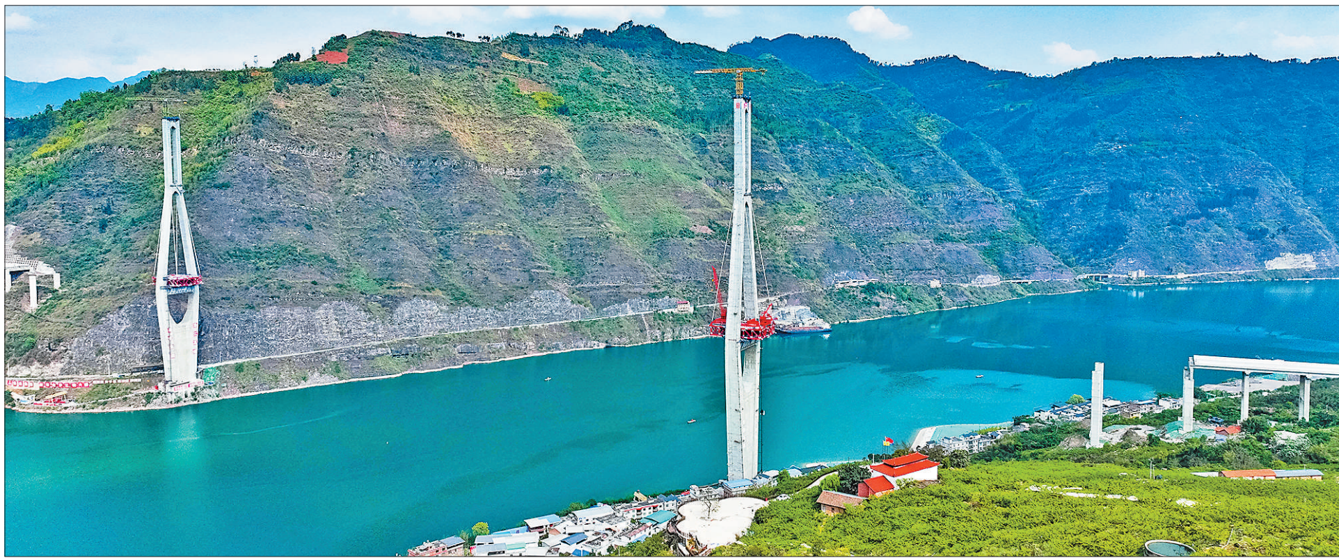
新市金沙江特大桥位于云南省绥江县南岸镇和四川省屏山县新市镇，全长1867米，桥跨680米，最大墩高297.51米，计划于2025年3月底实现全桥合龙。桥梁建成后，将便利群众出行，有力助推当地经济社会高质量发展。图为日前拍摄的大桥施工现场。
