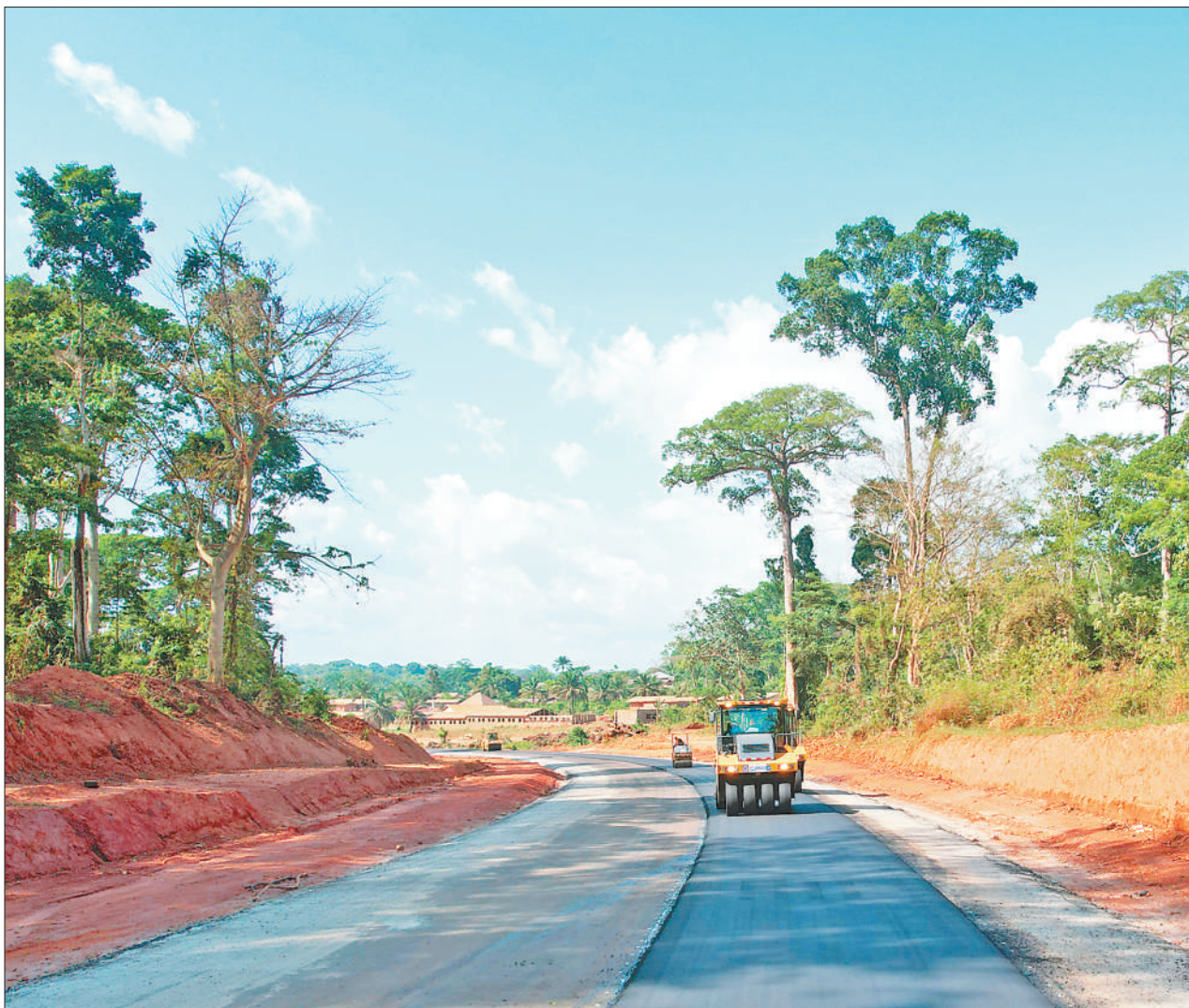
喀麦隆吕一曼金公路位于该国苏博拉高原南部，是首都雅温得连接北部各地区的重要通道，其中96.7千米管段由中铁二十局承建。这条公路建成投入使用后，将带动沿线省份的经济社会发展。图为公路沥青摊铺场景。
