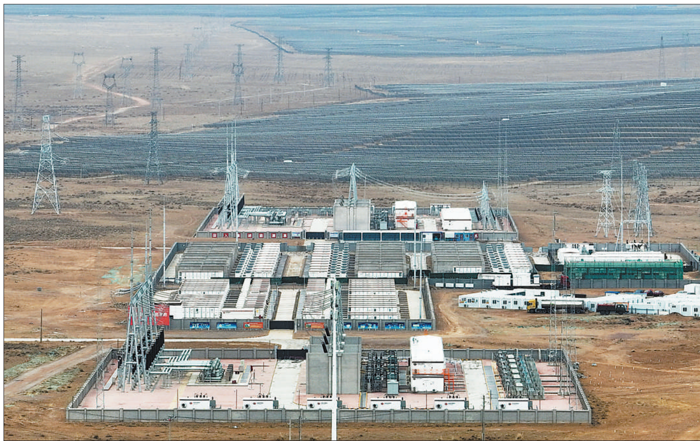
近日,位于宁东能源化工基地的国能曙光第一100兆瓦/200兆瓦时储能电站并网运行成功,标志着宁夏电网首个构网型储能电站并网投运。构网型储能被誉为电网的“多功能充电宝”,拥有灵活的涉网参数、快捷的响应速度。袁宏彦摄(影像中国)
