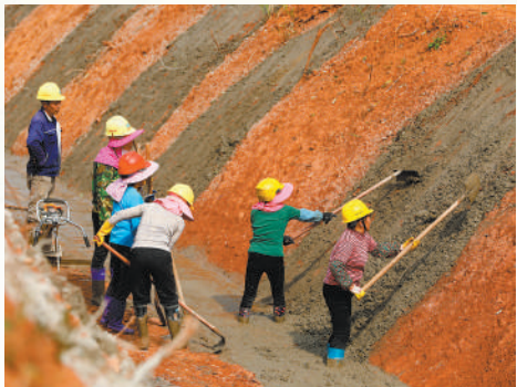
江西省吉安市泰和县上模乡，工人正在进行灌溉项目建设施工作业，保障春灌。
