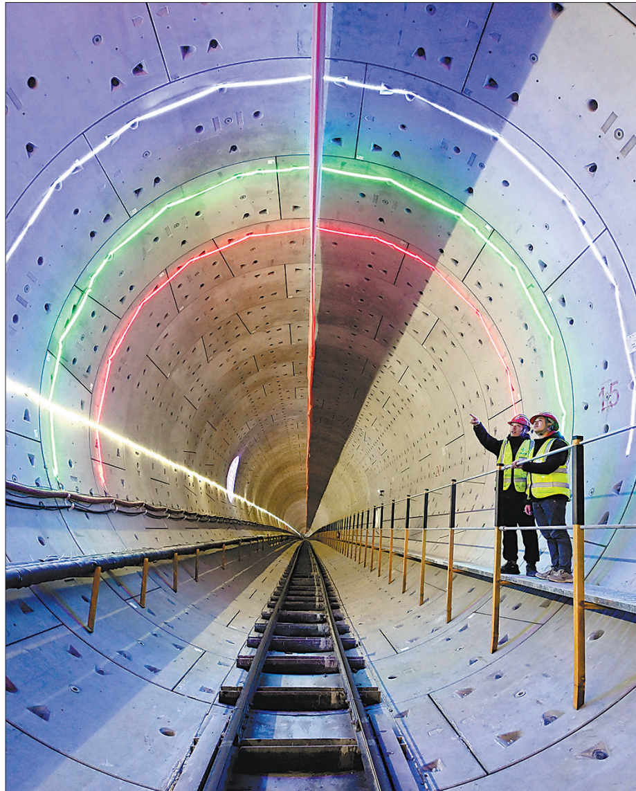
北京轨道交通22号线北段盾构隧道内，工作人员在进行巡查。新华社记者 王晓摄
