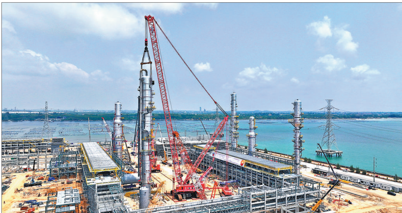
3月18日,泰国第七天然气处理厂项目最后一台大型塔器——闪蒸塔成功吊装就位,标志着该项目大型塔器吊装任务圆满完成。该项目是中泰两国落实共建“一带一路”倡议的重要工程,建成后天然气年处理能力可达50亿立方米,对于保障未来泰国能源供应、深化中泰两国能源合作具有重要意义。图为泰国第七天然气处理厂项目闪蒸塔进行吊装工作。 本报记者 白元琪摄
