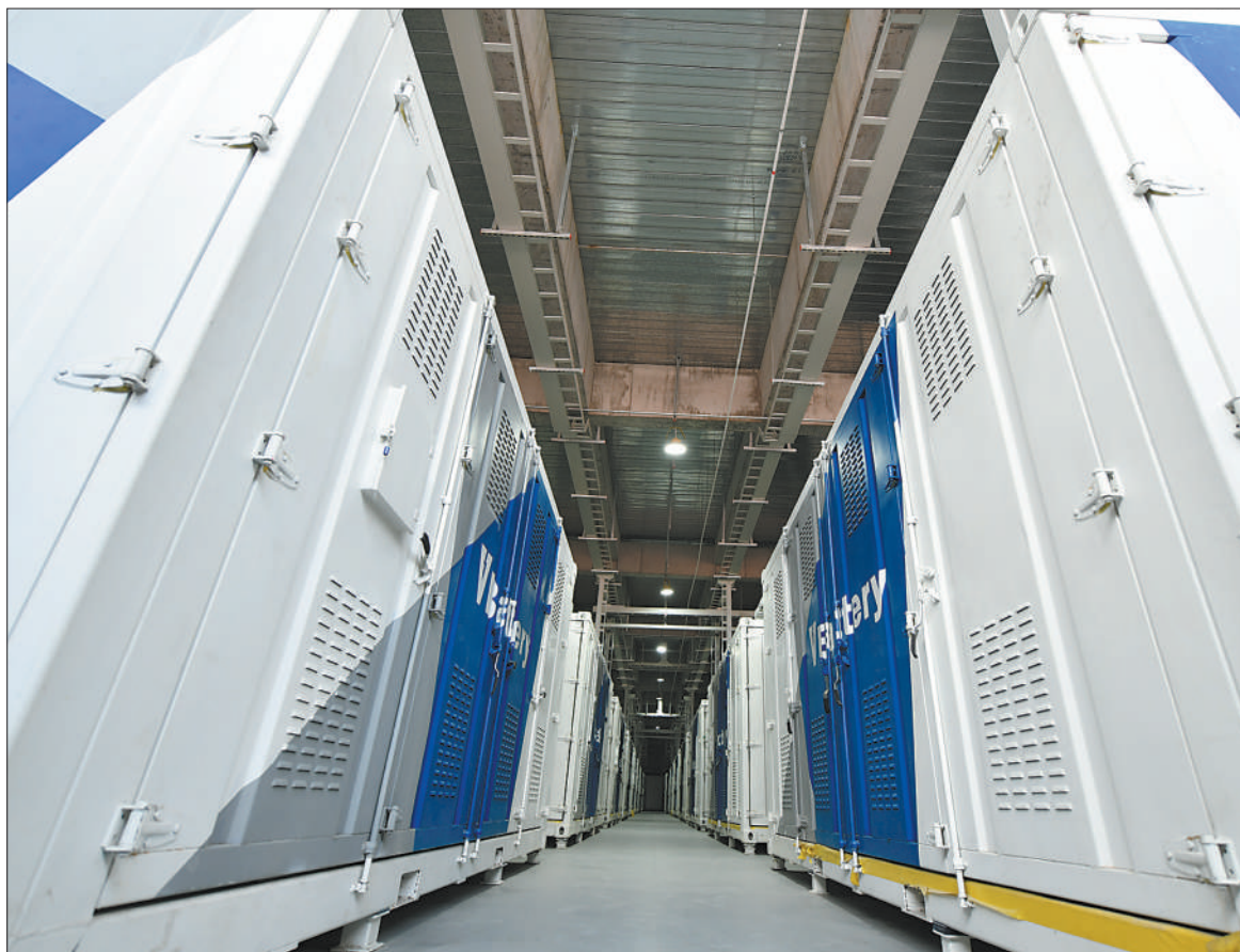
大连全钒液流电池储能调峰电站的电池集装箱。
