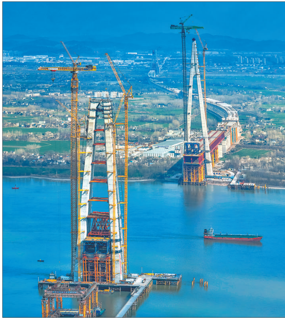
图为巢马城际铁路马鞍山长江公铁大桥主汉航道桥建设现场。
