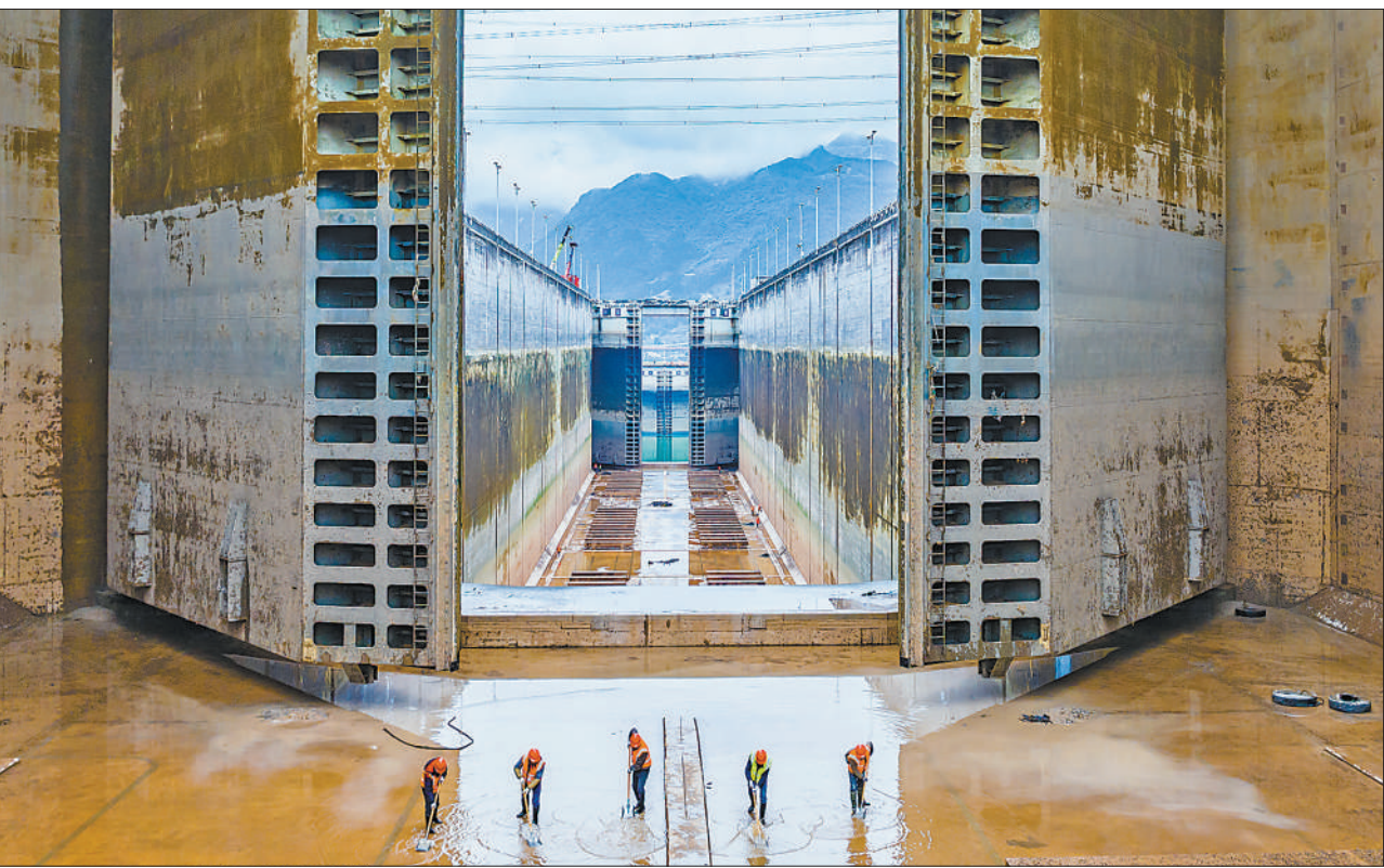
2月21日凌晨,三峡北线船闸2024年度计划性停航检修正式启动。此次检修工期为45天,计划于4月6日恢复通航。停航检修期间,三峡南线船闸实行单向通行,定时换向。三峡垂直升船机正常运行,符合通行条件的船舶可以快速过坝。图为2月21日,湖北宜昌,工人在三峡双线五级船闸北线闸室内作业。 本报记者 王浩文 郑家裕摄(影像中国)
