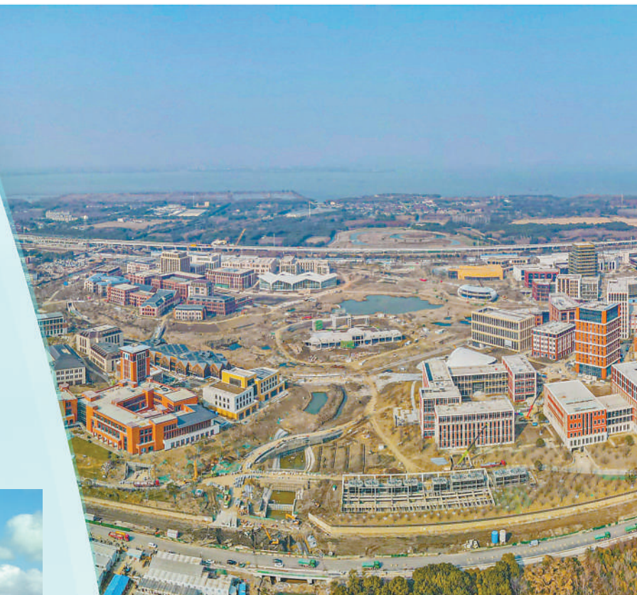
正在建设中的上海华为青浦研发中心。该项目总投资100多亿元,预计于年内竣工交付,交付后,可容纳约3.5万名研发人员办公。
