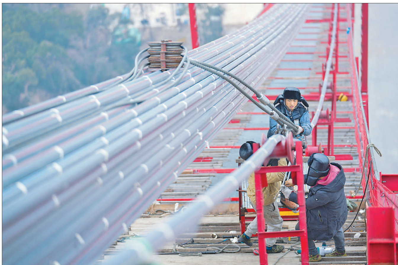
1月30日，在安徽，G3铜陵长江公铁大桥施工现场，施工人员进行主缆索股入鞍精调工作。当日，大桥最后一根主缆索股入鞍精调完成，下一步将推进紧缆、索夹和吊索安装等工序。大桥全长11.88公里，主跨988米，项目建成后将具有高速公路、城际铁路、货运铁路3种过江功能，对完善区域综合立体交通网具有重要意义。
