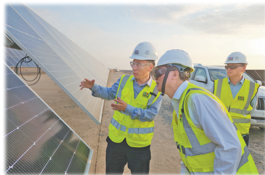
中企承建的沙特阿拉伯艾马尔达光伏电站是在建的全最大单体光伏电站。图为工作人员介绍电站情况。本报记者 管克江摄
