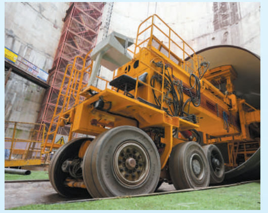
珠江三角洲水资源配置工程内衬施工阶段,一台车正在向输水隧洞内运送内衬钢管。 谢汉聪摄(人民视觉)
