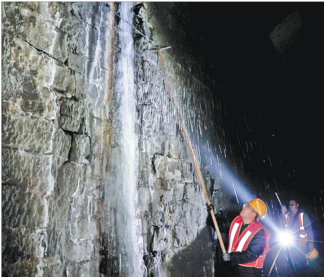
近日,山西忻州市经历了强降温天气,铁路隧道裂缝处渗出的积水冻结成冰。为确保列车行驶安全,国铁太原局原平工务段对管内隧道进行拉网式排查,除冰小队第一时间处理隧道内结冰,及时消除安全隐患,保障铁路运输安全畅通。 杨卫武摄(人民视觉)
