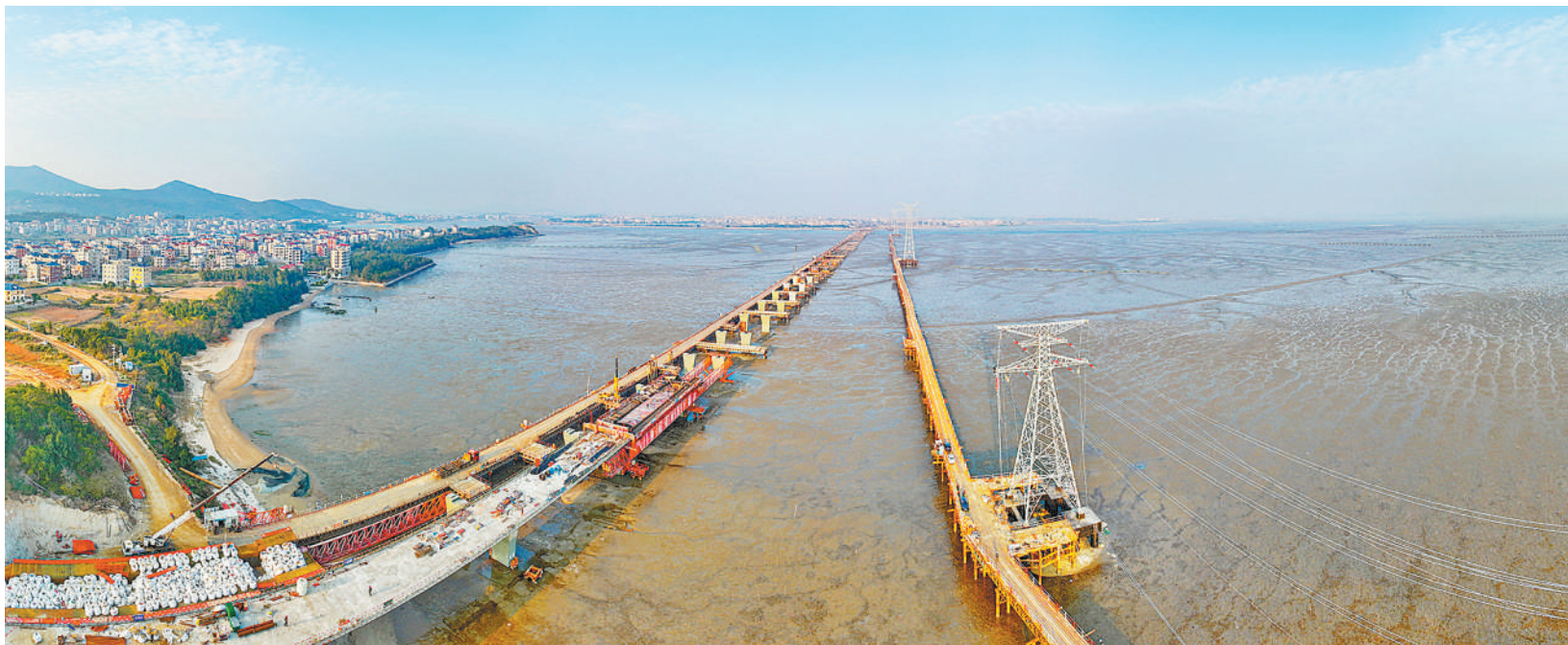
1月26日，位于福建省福清市的220千伏赤岸至华塘线路工程最后一相导线牵引完成，标志着国内跨海距离最长的架空输电线路全线贯通。该工程线路总长约30公里，架空线23.68公里。工程投产后，将进一步提高海上风电送出能力。图为工程施工现场。（谢贵明摄（影像中国））
