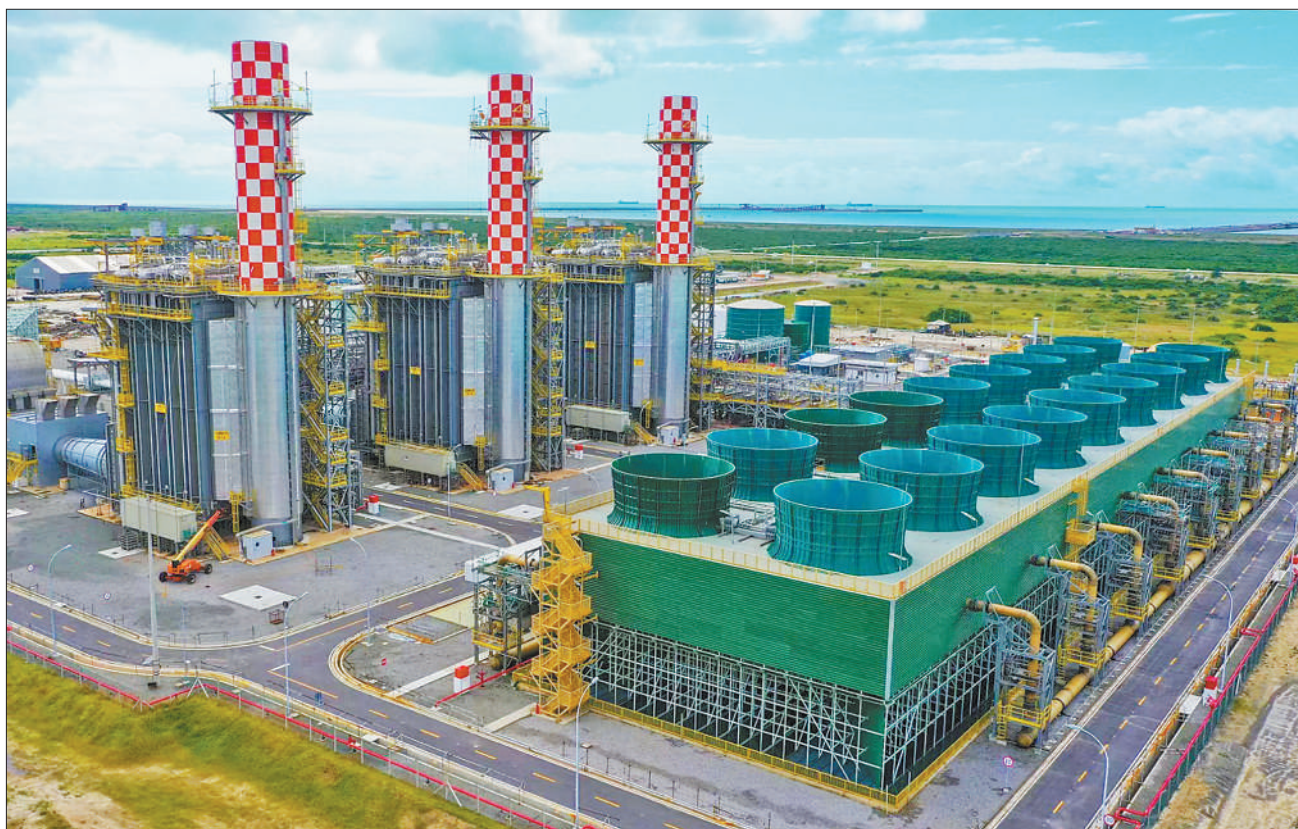
中国国家电力投资集团有限公司参与的阿苏港天然气综合体一期项目为巴西带来清洁可靠的电能，并通过推广液化天然气应用，有效促进能源转型。图为阿苏港天然气综合体一期项目。
