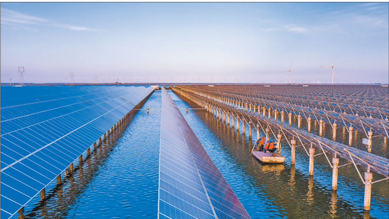
近年来,山东省滨州市无棣县充分利用沿海滩涂优势资源,发展“渔光互补”,当地电力部门优化网架结构,目前新能源装机容量已达89万千瓦。图为日前工作人员在“渔光一体”项目巡检。
