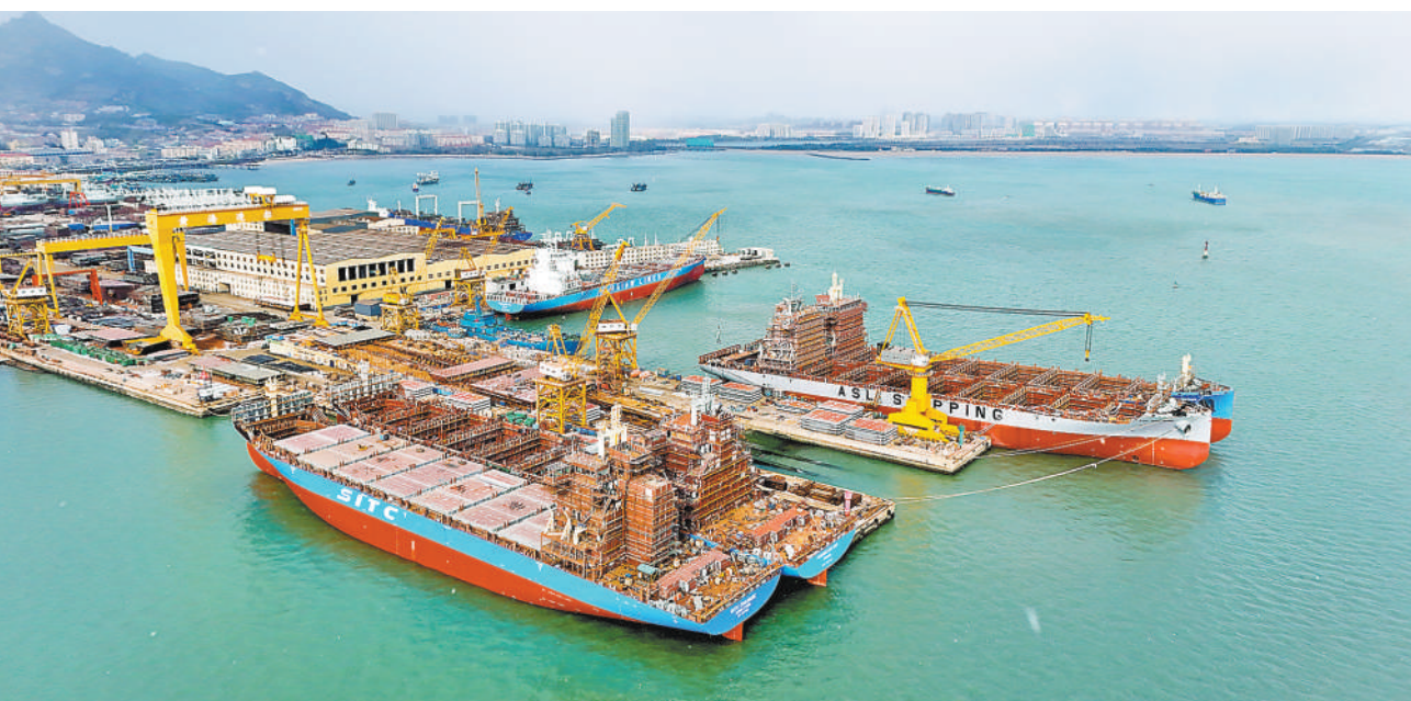
近年来,山东省荣成市积极推动船舶与海工装备产业高质量发展,加大技术创新和自主研发力度,强化产业链合作,船舶建造效率和技术含量显著提升。图为1月23日,荣成市一家造船公司厂区,多艘大型船舶正在加紧建造。 杨志礼摄(影像中国)
