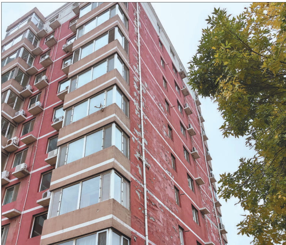
图为河北廊坊市香榭里舍小区,部分楼栋外墙墙皮脱落严重。 本报记者 向子丰摄 版式设计:沈亦伶
