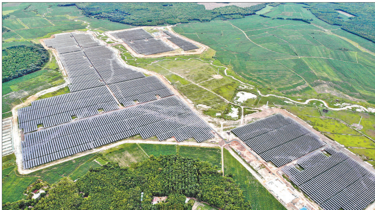
由中国能建集团安徽电建二公司承建的越南西宁市亚洲百科30兆瓦光伏电站。
