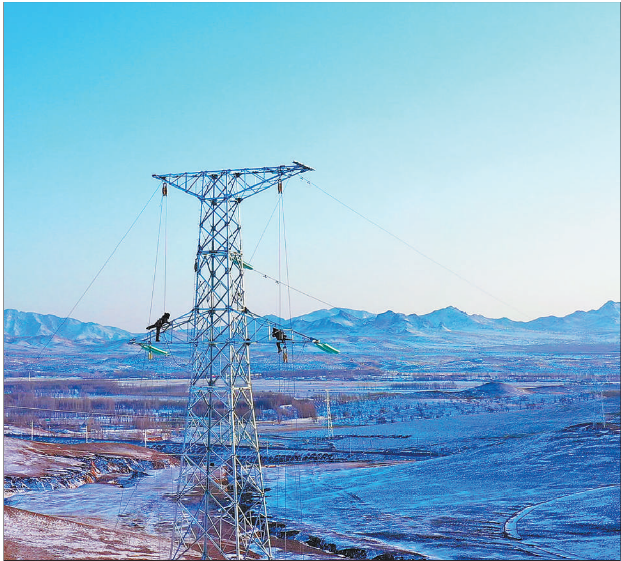
为迎接第十四届全国冬季运动会,国网蒙东电力赤峰供电公司投资700多万元对美林谷滑雪场66千伏变电站进行升级改造,抽调300余名电力员工集中备战,全力保障“十四冬”电力供应。图为工作人员在检查美林谷滑雪场周边的高压线路。张 彬 宋友军摄影报道
