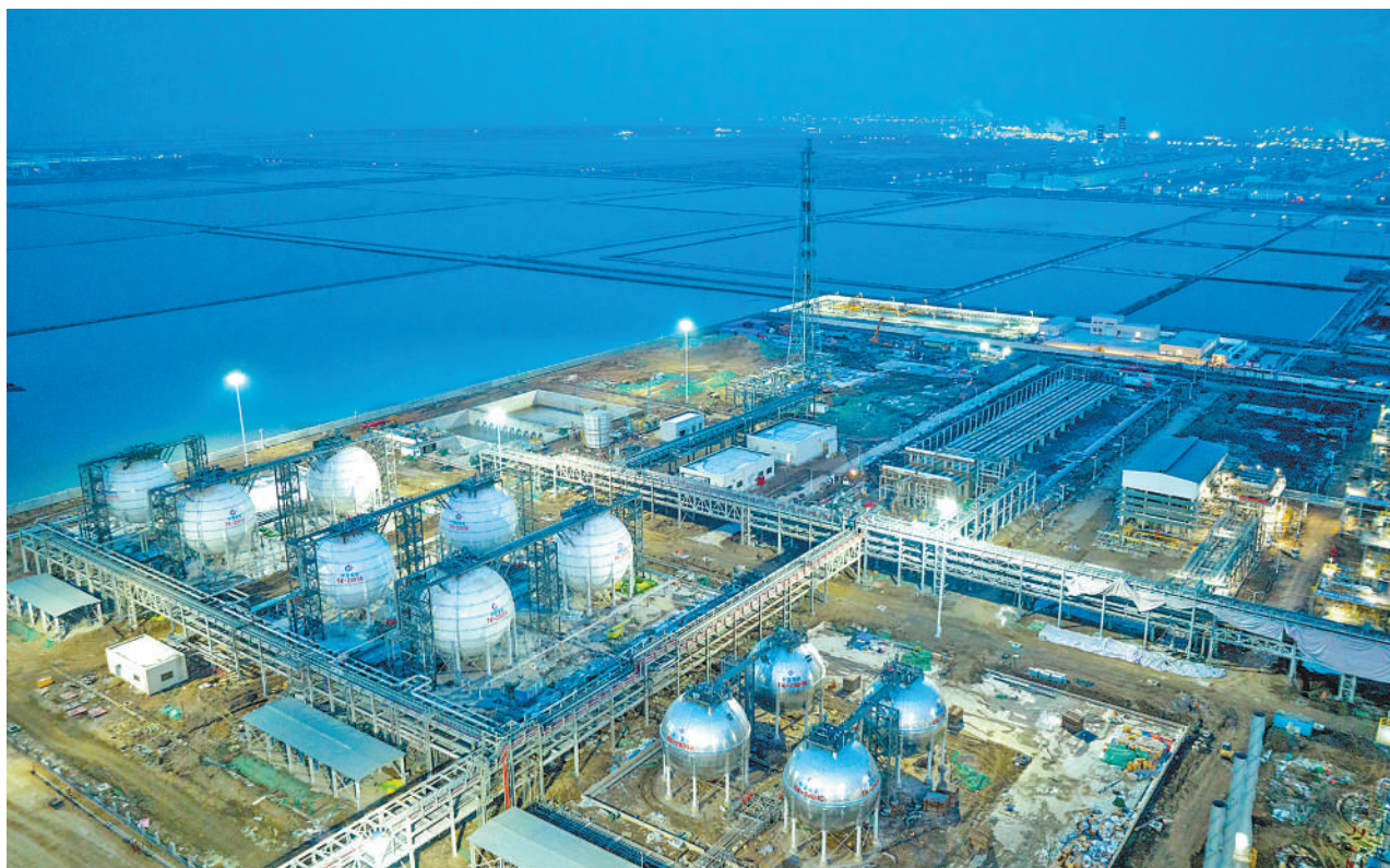
山东滨州天然气处理终端工程是渤海油田在建的大规模天然气终端项目,项目投产后将为我国华北地区提供稳定可靠的清洁能源。图为滨州天然气处理终端工程建设现场。 杜鹏辉摄(新华社发)
