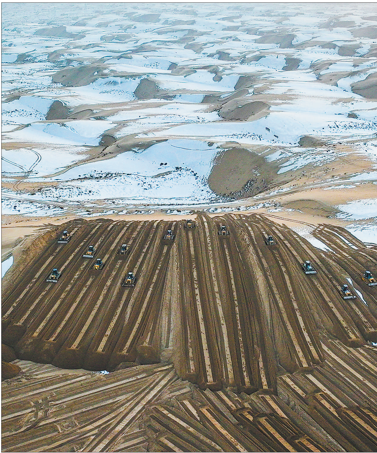
1月10日，在内蒙古鄂尔多斯市达拉特旗境内的库布其沙漠，大型机械设备在进行场平施工作业。据了解，正在建设的是内蒙古达拉特经济开发区增量配电网绿色供电项目。项目建成后，将助力当地加快构建清洁低碳高效的电力供应体系。 王晓博摄(影像中国)
