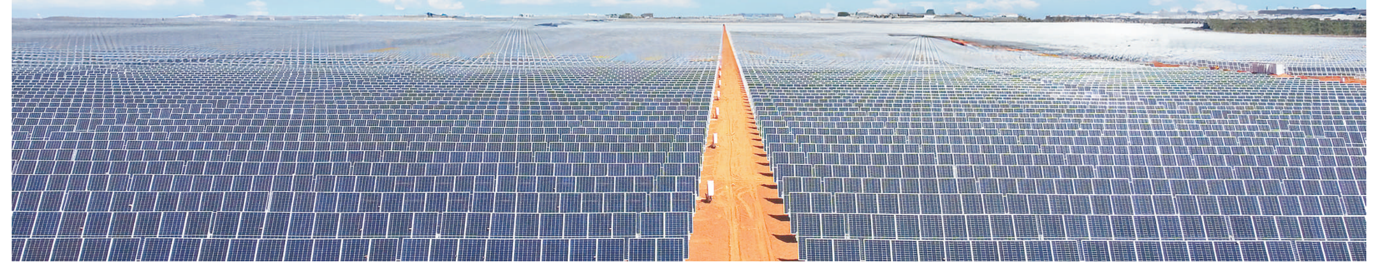
▼中国企业参建的巴西帕拉卡图圣若昂光伏群项目于2023年11月实现全容量并网发电。该项目全容量投产后,年均发电量约4.21亿千瓦时,每年可节约标煤约16.84万吨、减排二氧化碳41.97万吨,具有显著的经济效益、环境效益和社会效益,对推动巴西可再生能源的发展、缓解电力短缺作出贡献。图为帕拉卡图圣若昂光伏群项目的光伏方阵。 陈磊摄
