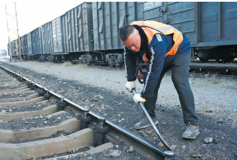
上图:范绍雄对固定减速顶的双头螺栓进行紧固。 左下图:太原北站远景。
