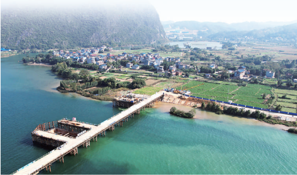
近日，广西壮族自治区融安县融江特大桥进行桥梁水下基坑开挖和墩柱施工。
