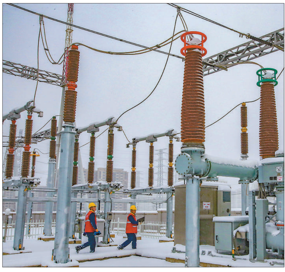
新疆乌鲁木齐，供电公司工作人员对重要线路、变电站进行不间断安全巡视，检查消除异常情况，确保恶劣天气下供电可靠安全。蔡增乐摄(人民视觉)
