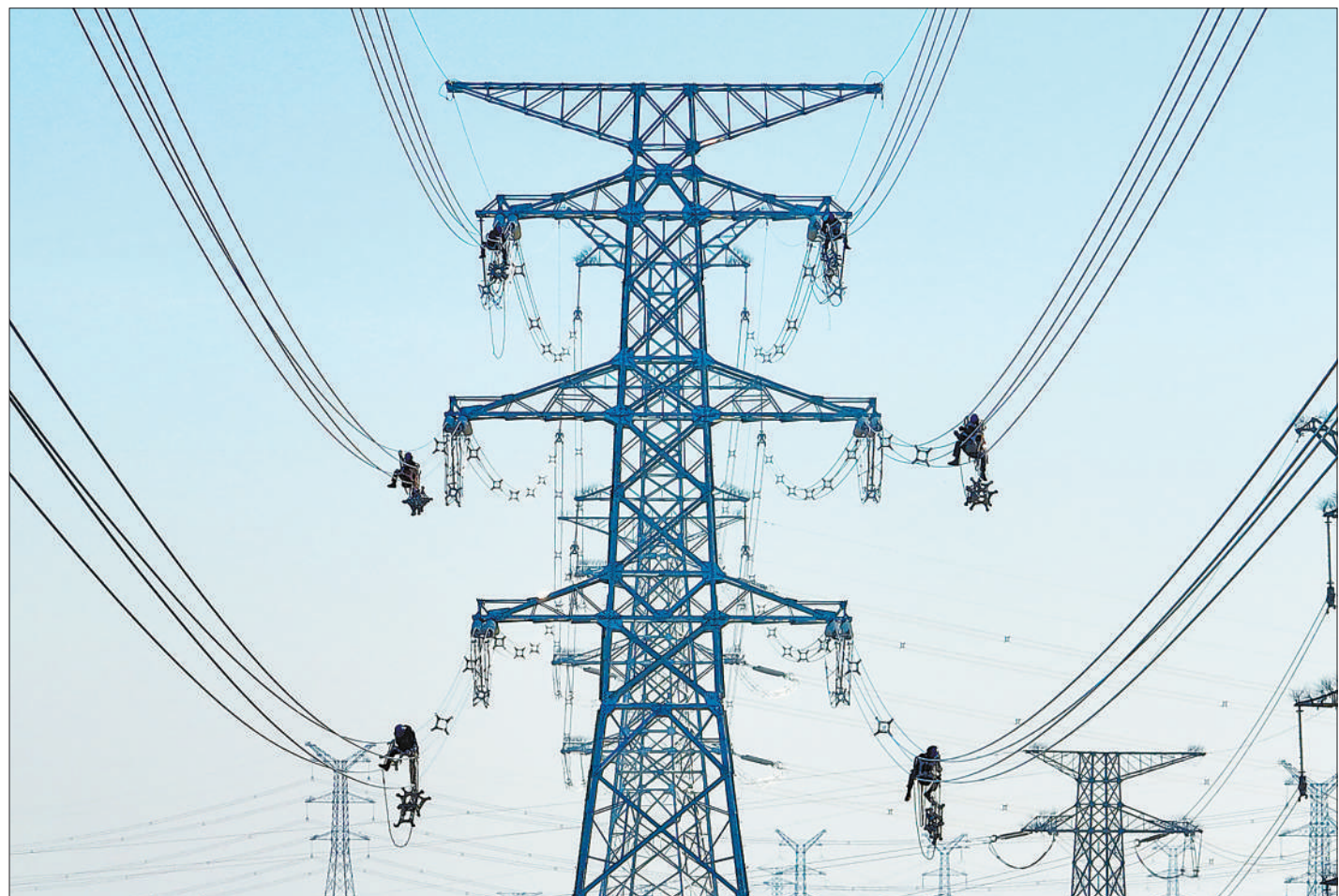
12月21日,电力工人在位于宁夏吴忠市境内的贺兰山—典农220千伏线路工程1—4号铁塔安装间隔棒。当日,随着电力工人将铁塔线路附件全部安装完毕,该工程总长73.9公里的输电线路全部贯通完成,为年底建成投运打下坚实基础。袁宏彦摄(影像中国)
