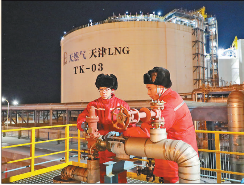
▲工作人员在中国石化天津LNG接收站巡检天然气管道。王军摄(新华社发)
