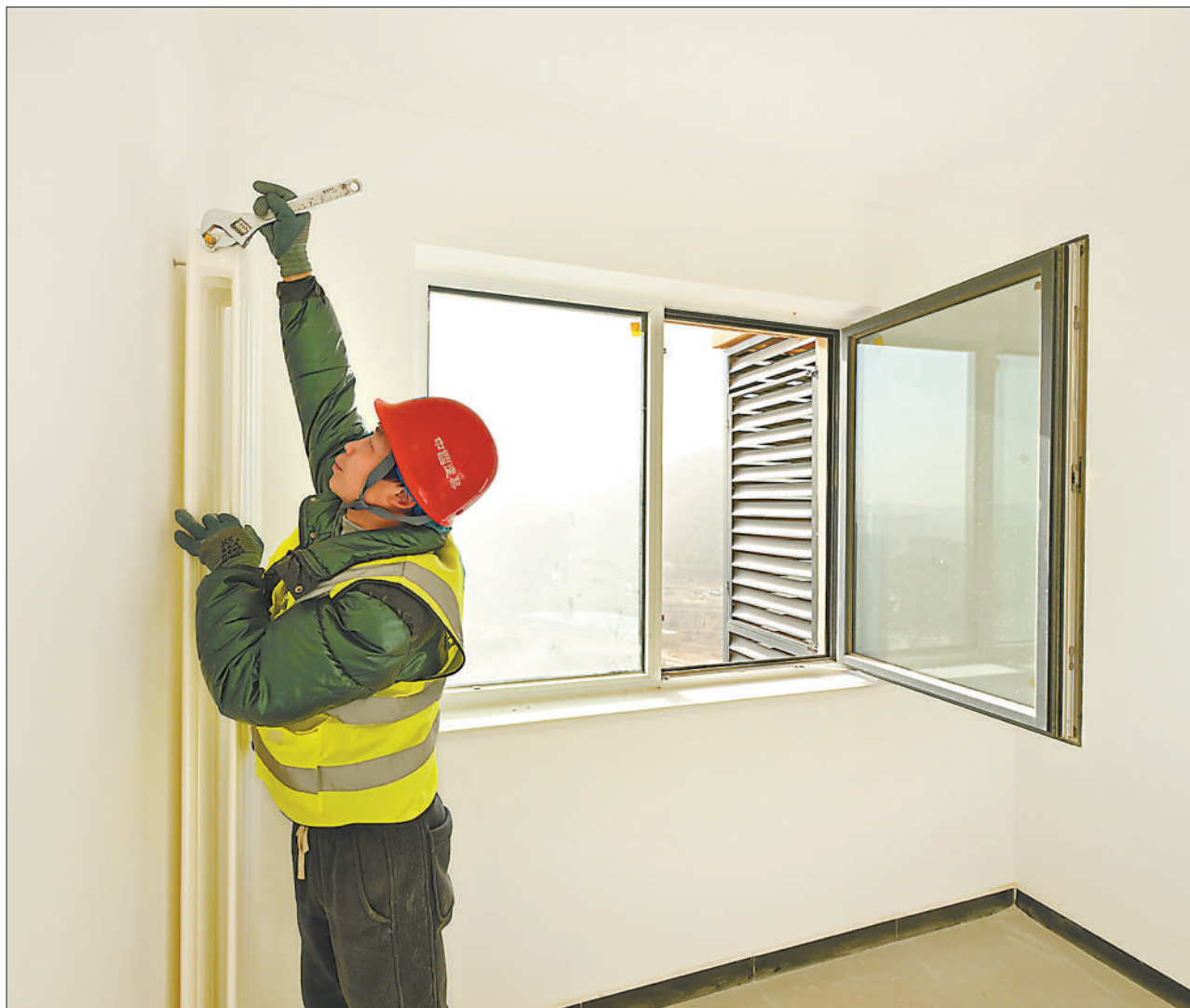
日前,北京市门头沟区一处棚户区改造项目施工现场,工人正在加紧安装暖气片等设施。该项目计划于今年12月底完成竣工验收,建成后将为当地居民提供995套住房。 本报记者 雷声摄
